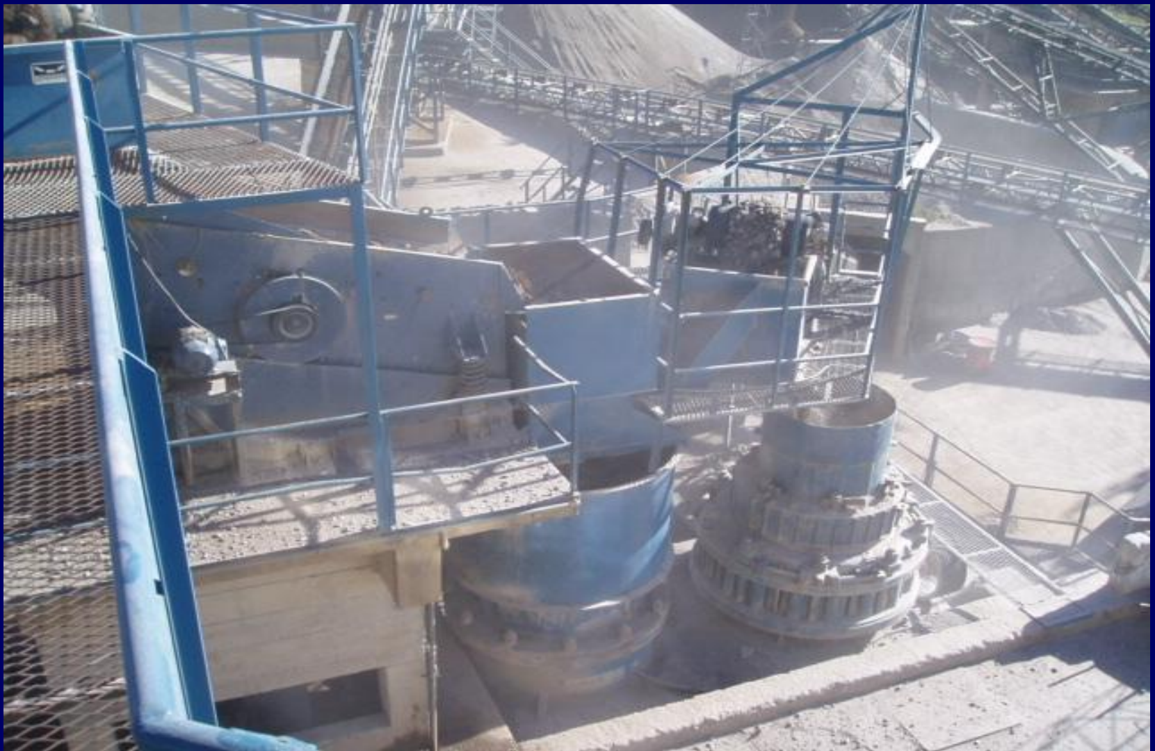
Britador primário e os coletores de britados.
